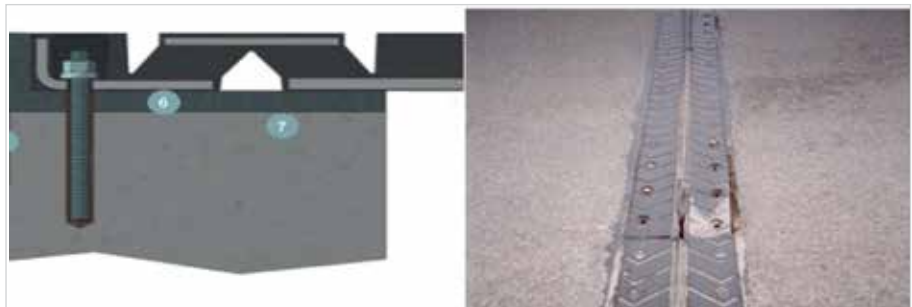
Рис. 13. Начальная стадия разрушения деформационного шва при закреплении секций при помощи анкеров
