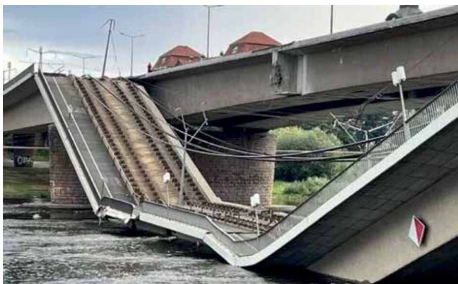
Рис. 1. Обрушение моста Carolabrücke через Эльбу в Дрездене (Германия) 11 сентября 2024 года https://ria.ru/20240911/drezden-1971976942.html?ysclid=m1rqykibx1347283808
