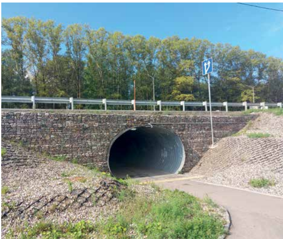
Рис. 5. Решение по устройству пешеходного перехода в подземном варианте вместо наземного, исключающее риски ударов автотранспорта в опоры и пролетные строения
