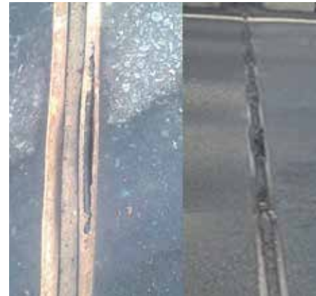
Рис. 9. В данном случае, несмотря на целостность конструкции, деформационный шов подлежит полной замене
