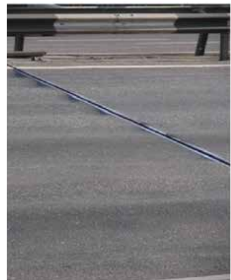
Рис. 10. Колееобразование на мостовом сооружении
