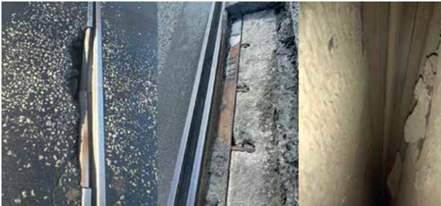
Рис. 8. Прогрессирующее разрушение деформационного шва и бетона омоноличивания
