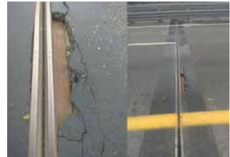
Рис. 7. Начальная стадия разрушения
