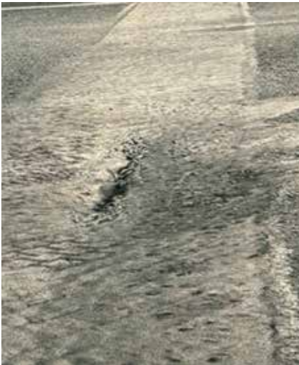
Рис. 2. Разрушение целостности деформационного шва
