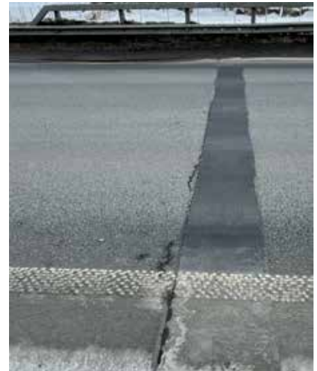
Рис. 4. Возникновение трещин между деформационным швом и асфальтобетонным покрытием
