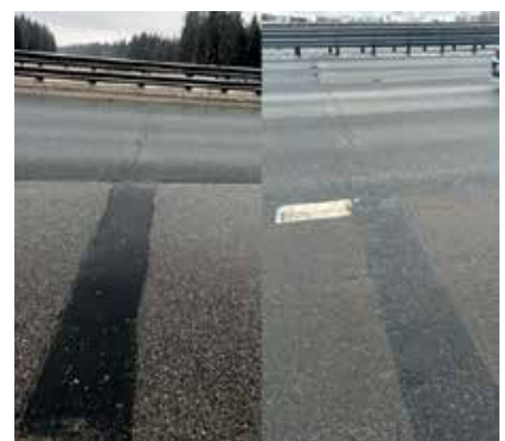
Рис. 5. Трещины в уложенном асфальтобетонном покрытии над существующим щебеночно-мастичным деформационным швом
