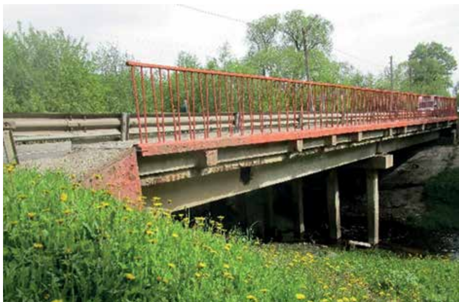
Рис. 1. Обследуемый мост через реку Речму на 2+150. Общий вид. Мост расположен на автодороге IV технической категории автодороги Серпухов – Новинки – Погари, в н. п. Бутурлино, Московской области
