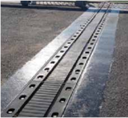
Рис. 11. Резинометаллический деформационный шов
