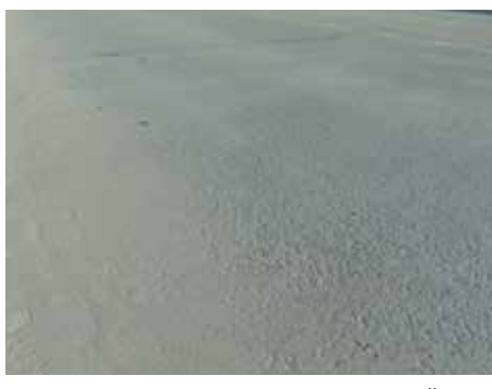
Шелушение с отслоением растворной части бетона
