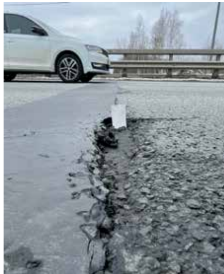
Рис. 3. Разрушение асфальтобетонного покрытия в зоне деформационного шва
