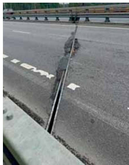
Рис. 2. Разрушение в зоне деформационного шва
