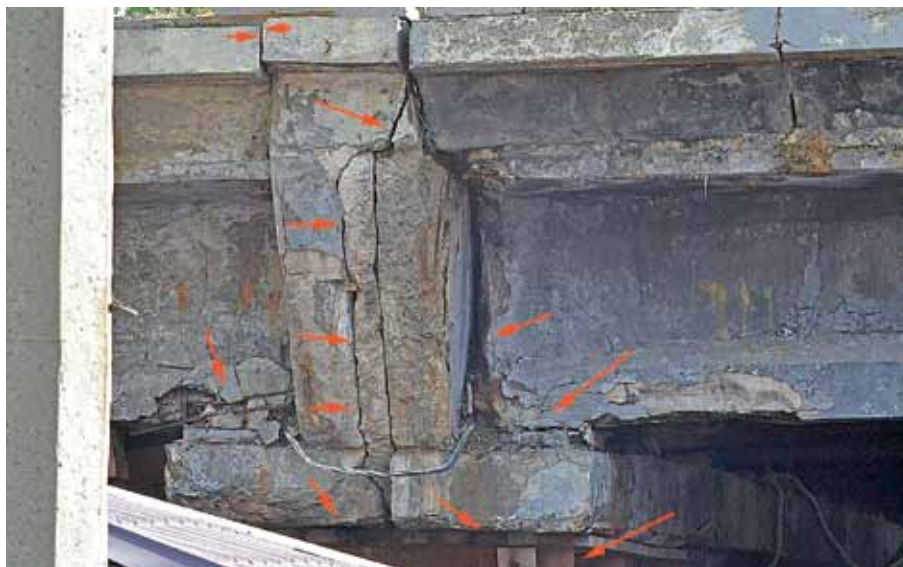
Рис. 3. Повреждения железобетонных пролетных строений из-за попадания влаги
