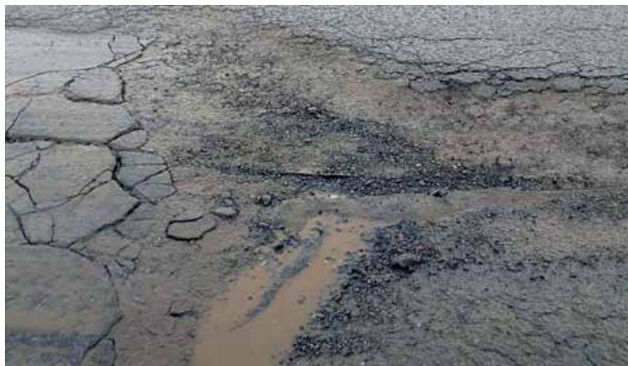
Рис. 4. Пример характерного повреждения дорожной одежды с оклеечной гидроизоляцией на мостовых сооружениях Саратовской области
