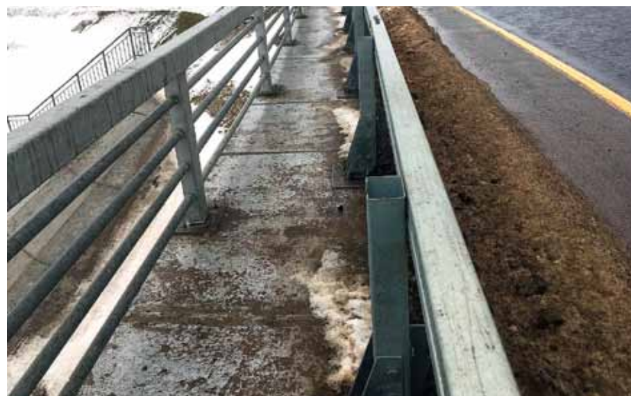
Фото 4. ПК 0+48. Скопление и удержание влаги и грязи на поверхности тротуара и проезжей части
