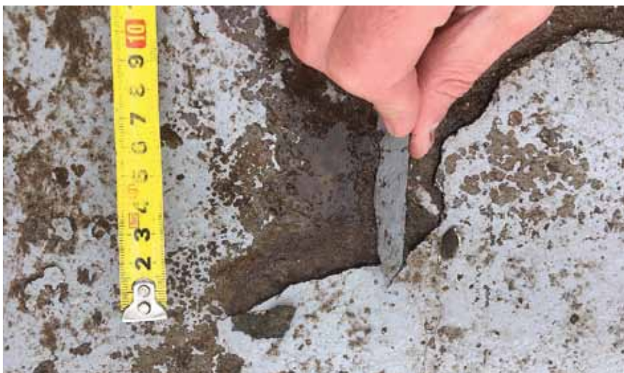
Фото 2. Технологический проход ПК 2+52. Разрушение поверхности бетона вместе с лакокрасочным покрытием
