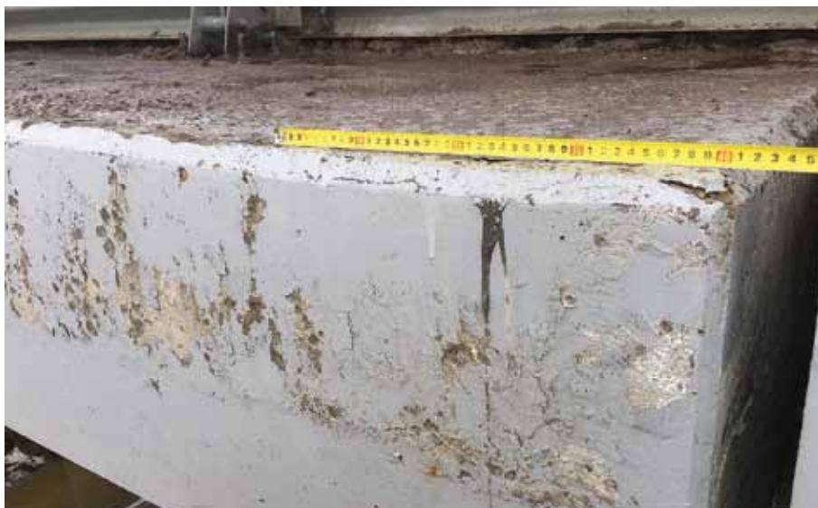
Фото 1. Разрушение поверхностного слоя бетона
