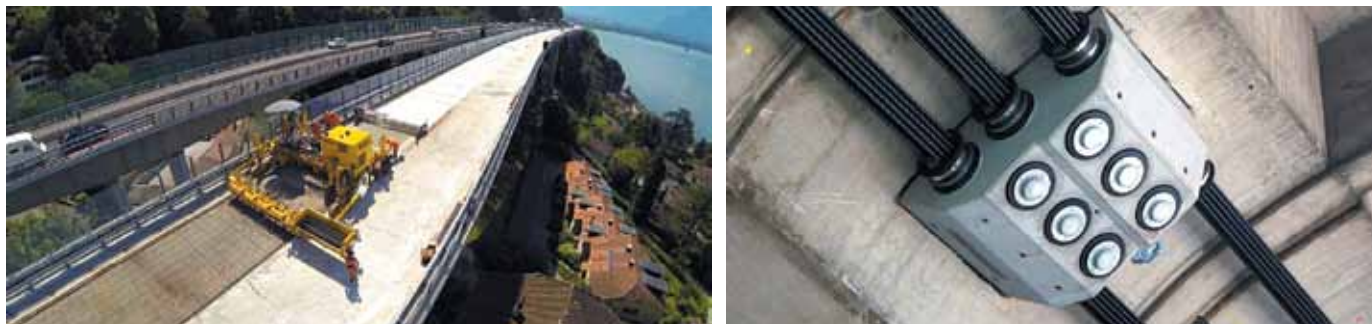
Рис. 12. Уложенные в качестве добавленного слоя 53 тыс. м 2 Ductal® на виадуке Chillon (Швейцария) / Анкерные блоки из Ductal® для системы дополнительного внешнего предварительного напряжения эстакады Hammersmith (Великобритания)
