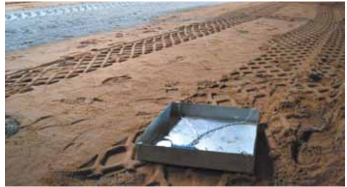
Фото 8. Оборудование для контроля дозировки вяжущего
