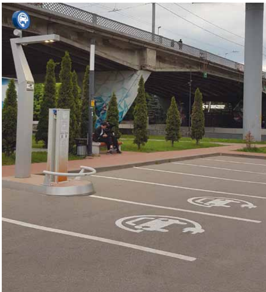
Рис. 5. Станция зарядки электромобилей с горизонтальной дорожной разметкой, не соответствующей ГОСТ Р 51256-2018
