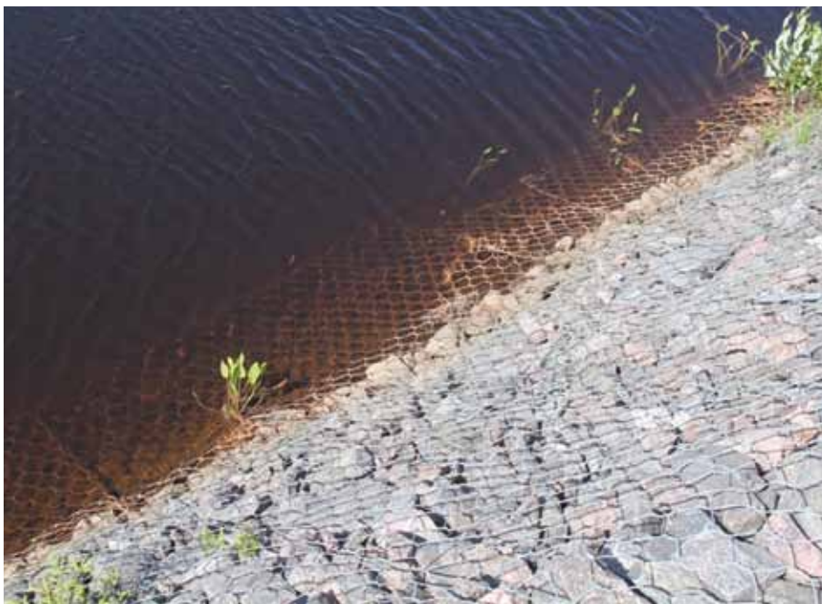
Рис. 2. Коррозия сеток габионных конструкций в прудах реальных ГБП
