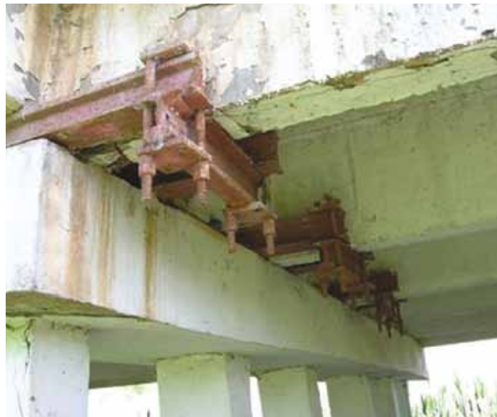
Рис. 4. Передача нагрузки на ригель от балок с поврежденными торцами
