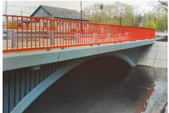
Рис. 12. Малый грунтозасыпной мост с трубобетонными арочными несущими элементами с оболочкой из полимерного композитного материала
