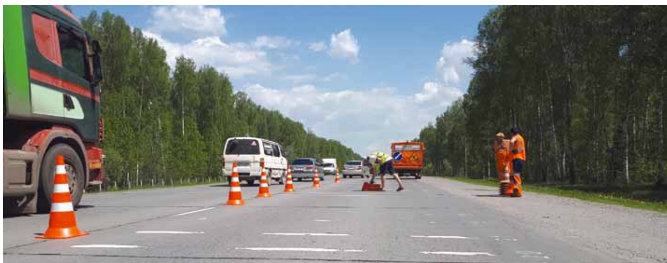
Рис. 5. Контрольные линии через двенадцать месяцев эксплуатации (десять месяцев – для полимерных лент). Автомобильная дорога Р-255 «Сибирь» на участке Северного обхода г. Новосибирска, км 29 (с цементобетонным покрытием)
