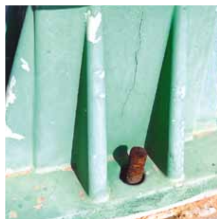
Рис. 22. Отсутствие гайки на шпильке, а также соединение элементов с натягом, что приводит к образованию трещин и впоследствии к разрушению конструкции
