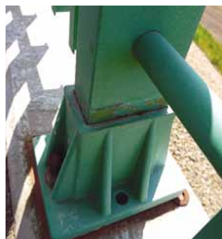
Рис. 21. Неплотное прилегание к плите проезжей части и осевое вертикальное и горизонтальное отклонение
