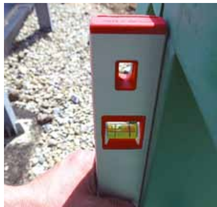
Рис. 18. Отклонение стойки перильного ограждения от вертикальной оси
