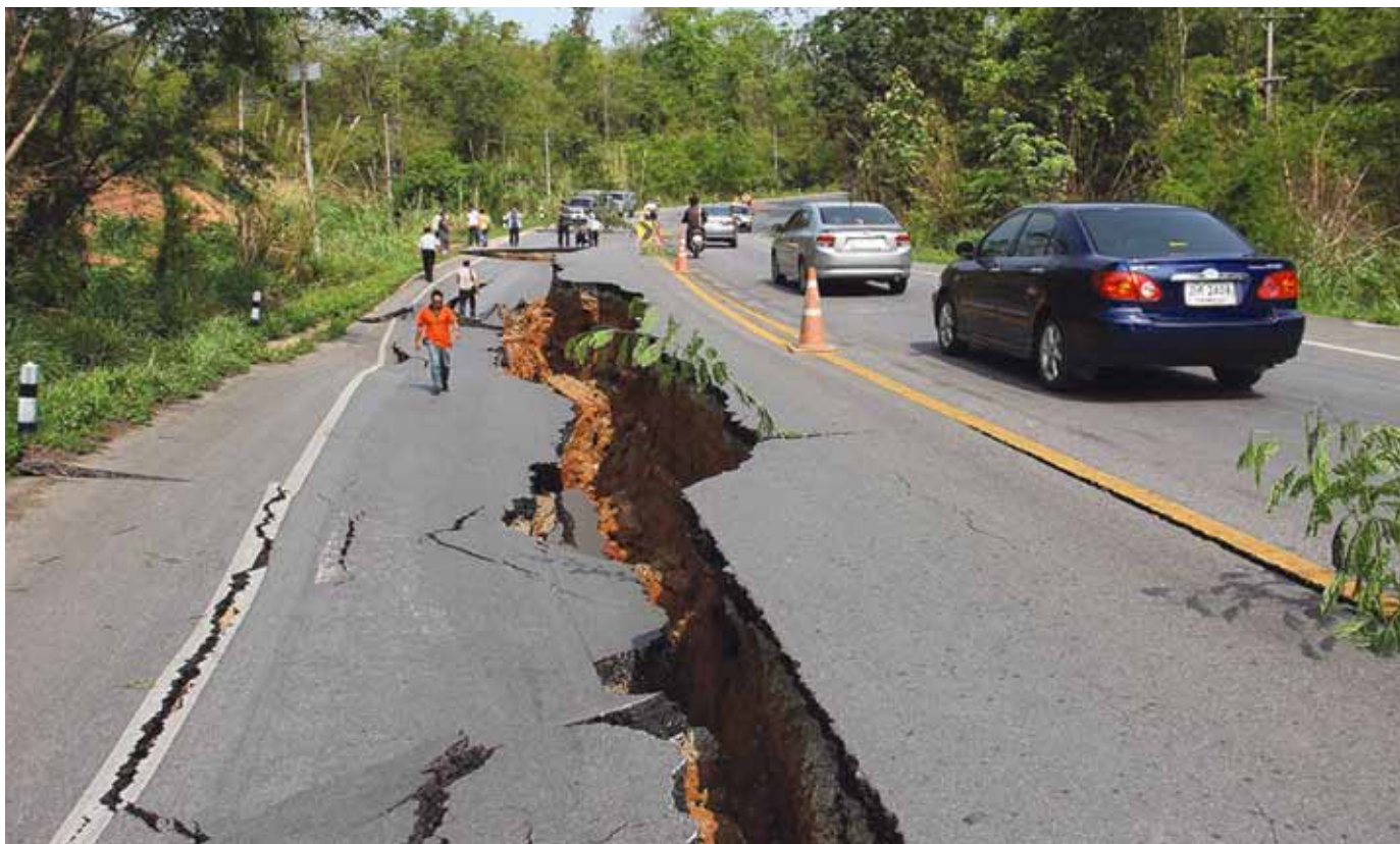
Повреждения дороги землетрясением в Таиланде
