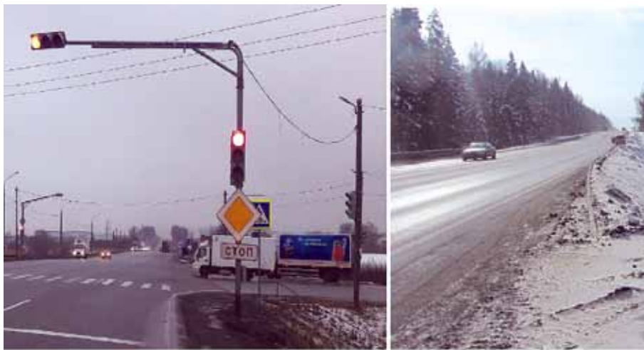
Пример аварийно-опасных участков автодорог: плохо различимый светофор, дефекты зимнего содержания (не видно барьерное ограждение)
