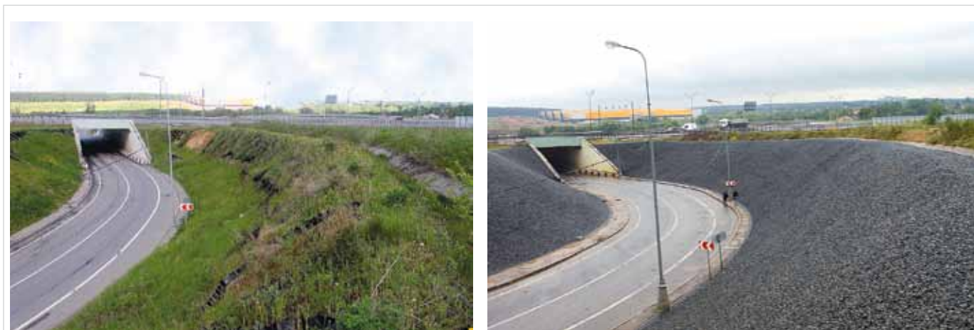
Состояние объекта «Боровское шоссе (развязка с Киевским шоссе)» до и после проведения работ по укреплению откоса вяжущим материалом и после укрепления.
