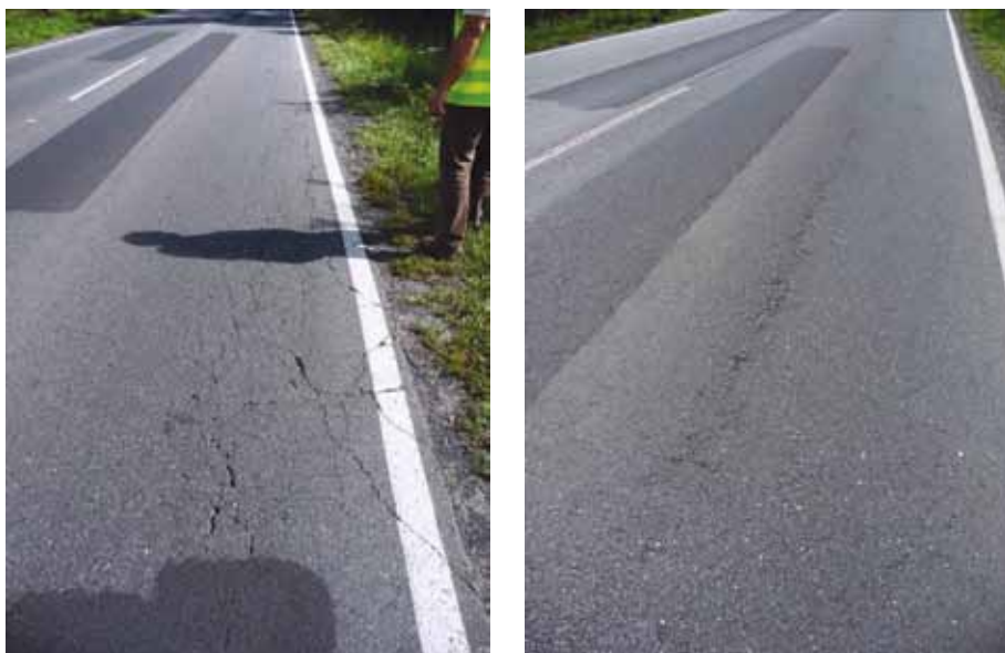
Рис. 7. Состояние старого покрытия участка дороги DW793 Бедуж – Мышкув перед укладкой 4 см слоя износа NiMA. Август 2014 г.
