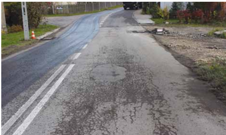
Рис. 8. Состояние покрытия участка дороги DW789 в г. Калеты. Октябрь 2013 г.
