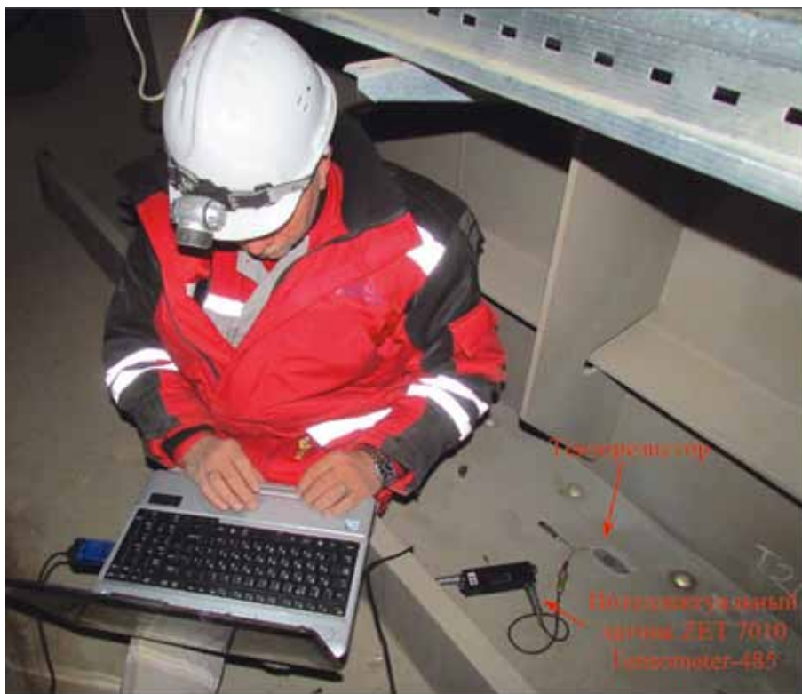
Рис. 5. Тензодатчик системы ZET LAB, установленный на нижнем поясе главной балки Б1 в середине пролета V-25л - V-26л левого пролетного строения мостового перехода в устье рек Средней и Большой Невки
