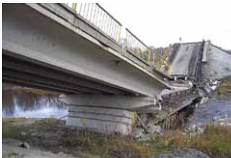
Рис. 2. Авария моста через реку Тартас, 2005 г. (г. п. 1978)
