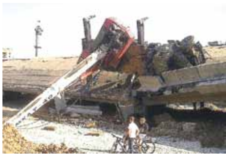
Рис. 3. Авария строящегося путепровода в Екатеринбурге, 2006 г.
