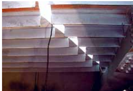
Рис. 4. Авария строящегося моста через протоку Юганская Обь, 2006 г.
