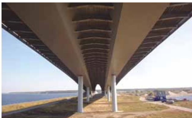
Состояние бетонных и металлических конструкций Президентского моста в 2016 году
