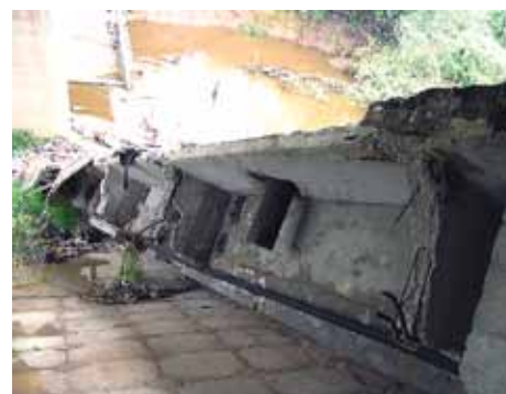
Рис. 5. Обрушение крайней балки моста через реку Вельгию у г. Боровичи
