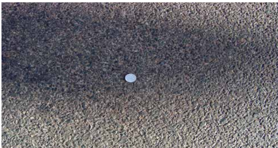
Фото 3. Текстура покрытия, состоящего из литого и вибролитого асфальтобетона после трех лет эксплуатации (Москва, Батайский проезд, 2014)
