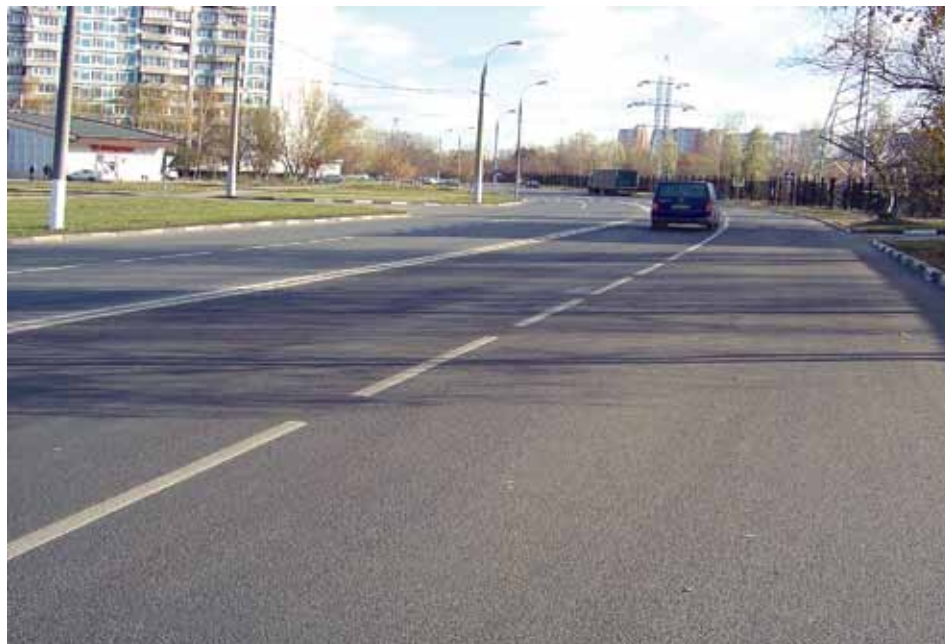
Фото 2. Вид покрытия после трех лет эксплуатации (Москва, Батайский проезд, 2014)
