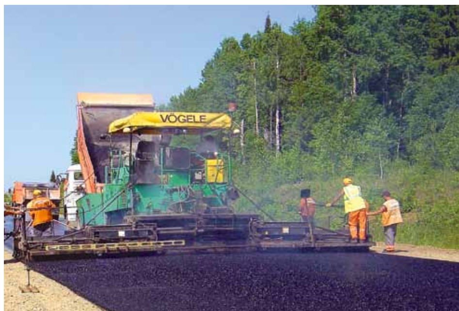
Фото 8. Процесс устройства шероховатого тонкослойного покрытия из высокощебенистой вибролитой смеси ВЛА-15 после устранения колеи. Толщина слоя – 30 мм (автомобильная дорога Болгары – Юго-Камский – Крылово, Пермский край, июль 2006)
