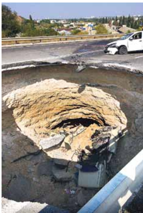
Рис. 1. Разрушенный участок Симферопольской объездной автомобильной дороги на участке Мирное – Дубки
