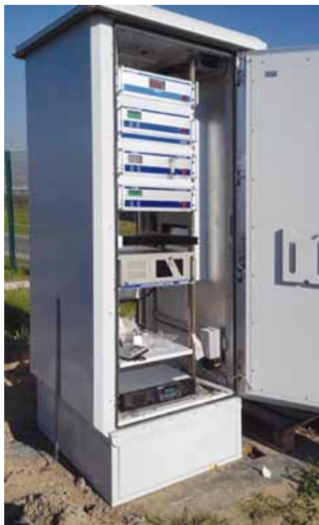
Рис. 7. Станция автоматического контроля загрязнения атмосферного воздуха, установленная на КАД
