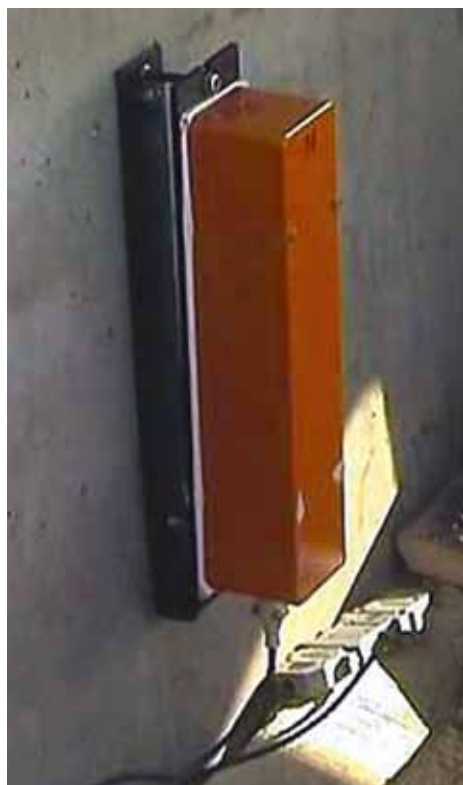
Рис. 2. Инклинометр на оголовке опоры
