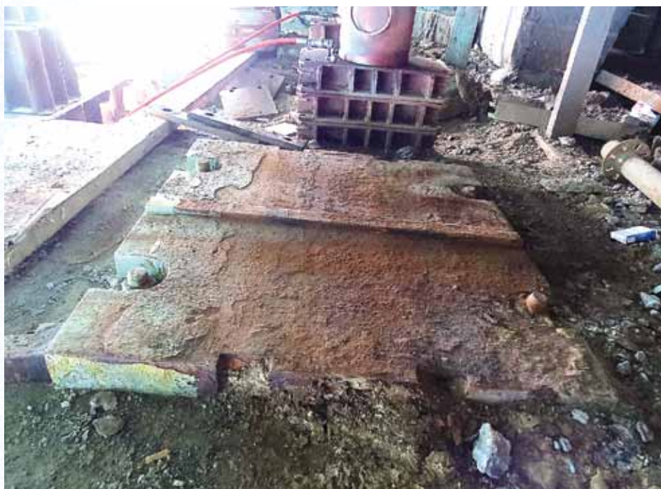
Рис. 8. Нижняя плита опорной части после демонтажа катков и верхнего балансира. Пластиночная коррозия плиты
