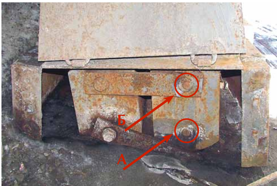
Рис. 5. Опора № 1, опорная часть № 8 справа. Болт нижней планки срезан (А), болт верхней планки заменен на нестандартный (Б). Со стороны шкафной стенки нагромождение земли со льдом
