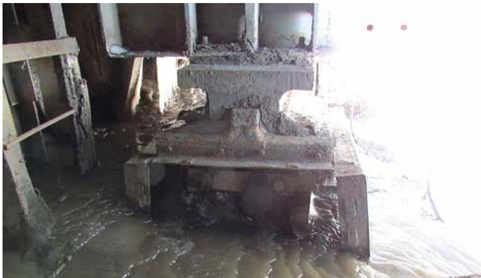
Рис. 7. Опора № 5, опорная часть № 1 слева. Отсутствие защитного кожуха, загрязнение и обледенение опорной части
