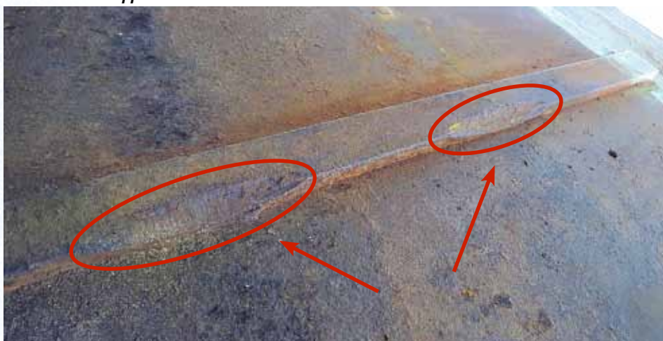
Рис. 10. Повреждение (выработка) гребня нижней плиты
