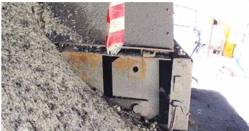
Рис. 6. Опора № 1, опорная часть № 2 справа. Отсутствует соединительная планка, 1 болт срезан, 1 болт отсутствует, опорная часть засыпана снегом и землей
