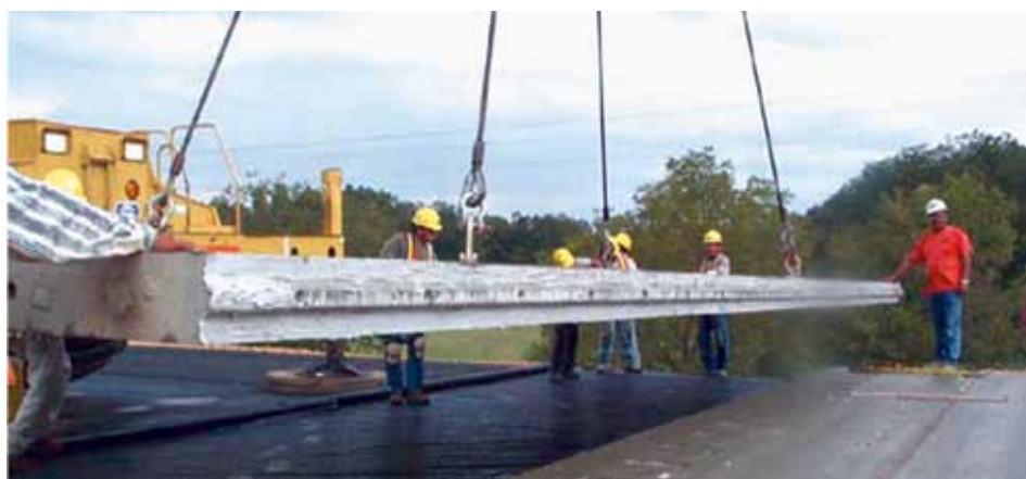
Рис. 3. Подача бетонной плиты сборного типа на дорожное земляное полотно с подсыпкой дренирующего песчаного слоя, укрытого полиэтиленовой пленкой. (По торцу плиты видны отверстия для ввода стягивающих стальных канатов)
