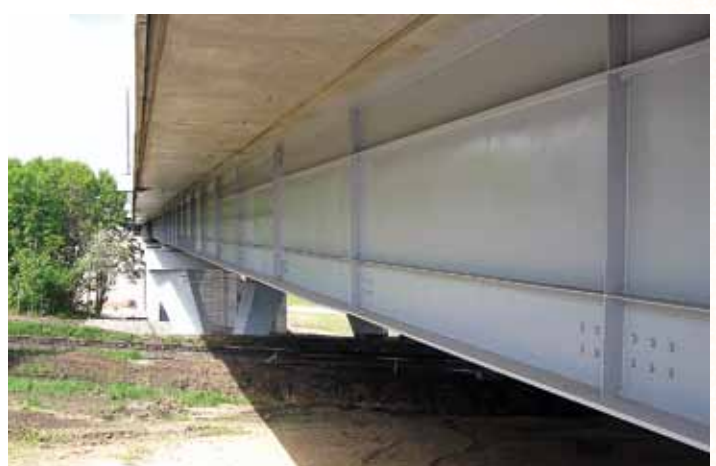
Мостовая металлоконструкция с антикоррозийной защитой, выполненной с применением лакокрасочных материалов компании Jotun (Норвегия). Применение: автодорога М-4 «Дон»
