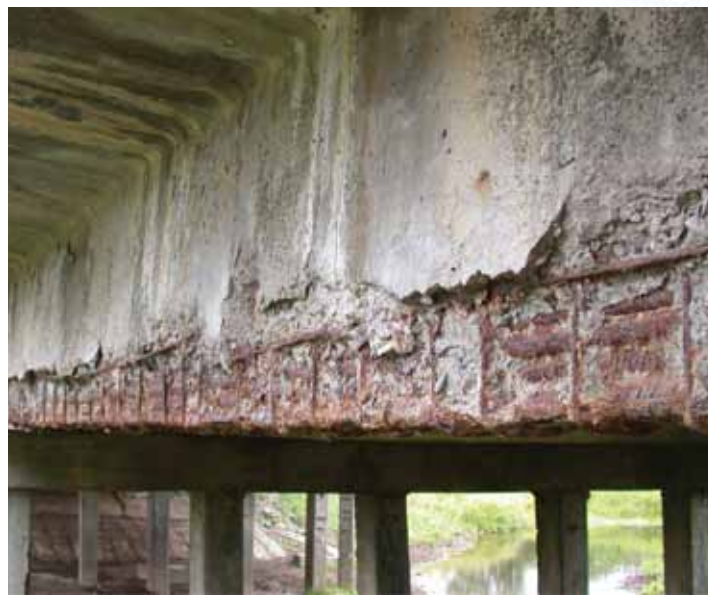
Рис. 3. Состояние крайних балок типового железобетонного пролетного строения моста через 34 года эксплуатации
