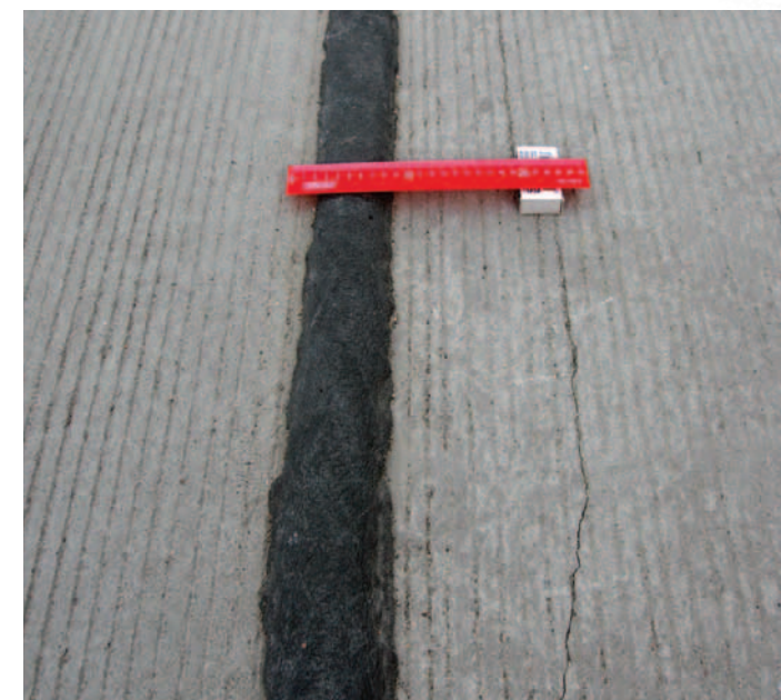
Рис. 2. Выпирание швов теплового расширения на АВК-1. Видна сквозная трещина вдоль шва
