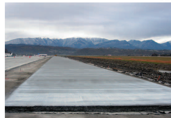
Рис. 4. Свежеуложенная полоса цементобетонного покрытия. Аэропорт Адлер, наблюдается неравномерность пленкообразующего покрытия на поверхности бетона (16.12.2009)
