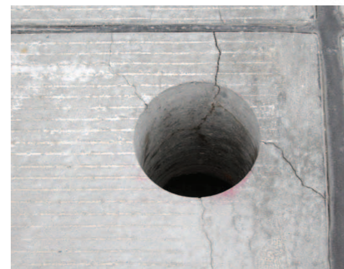
Рис. 3. Перрон АВК-1. Отверстие от керна в угловой части плиты
