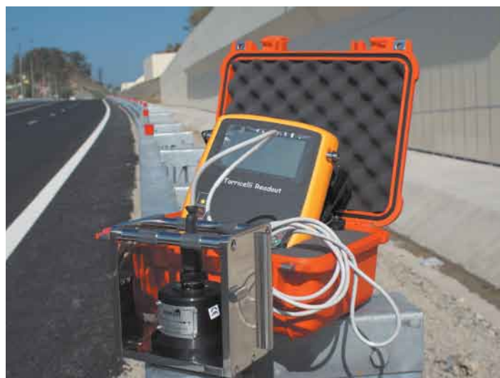
Рис. 4. Комплект измерительного и регистрирующего оборудования для контроля наклона подпорной стенки
