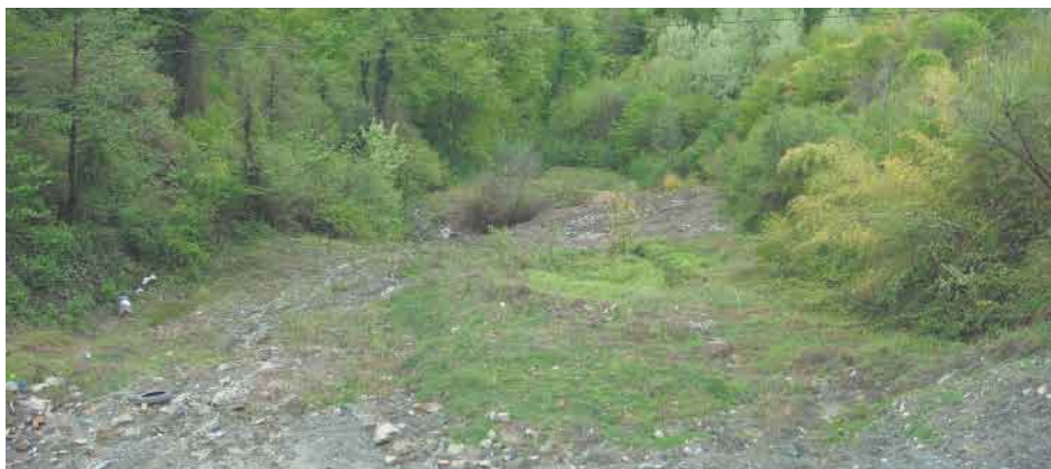
Рис. 1. Потенциально оползневый участок ПК 88–89 (вид с дороги)
