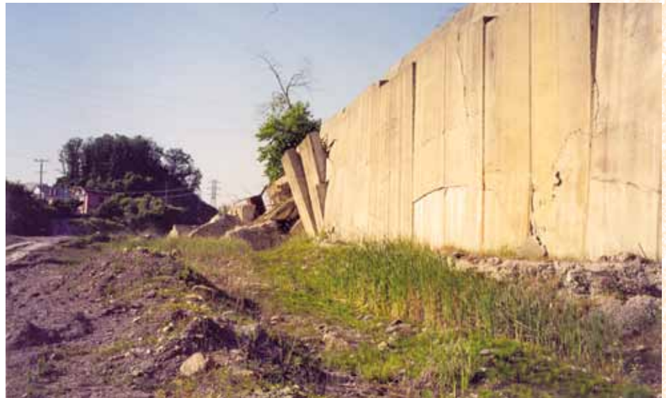
Рис. 2. Разрушение оползневым давлением подпорной стены на участке ПК91 – ПК93
