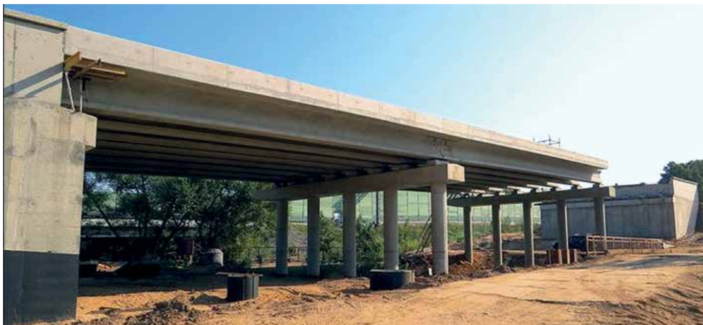
Рис. 3. Общий вид автодорожного моста (г. Москва) на момент приостановки СМР
