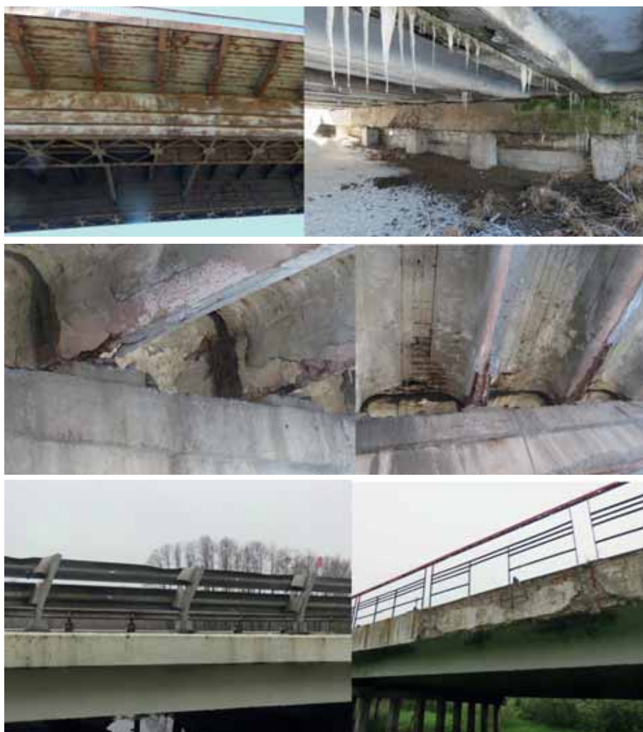
Рис. 1. Дефекты мостовых сооружений
