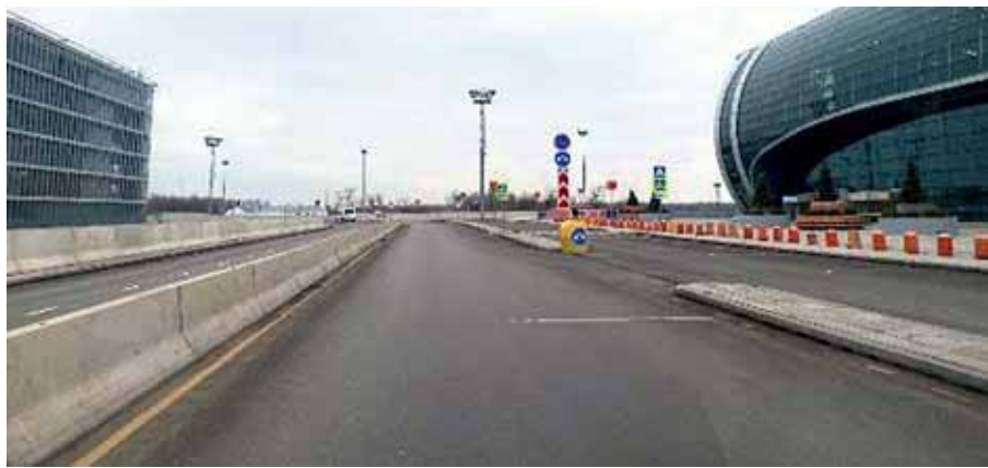
Рис. 7. Состояние покрытия из литого асфальтобетона после 5 лет эксплуатации
