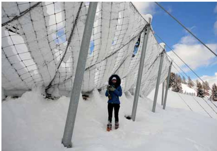
Снегоудерживающие барьеры ОМ-СУБ (установлены в зоне зарождения лавин)
