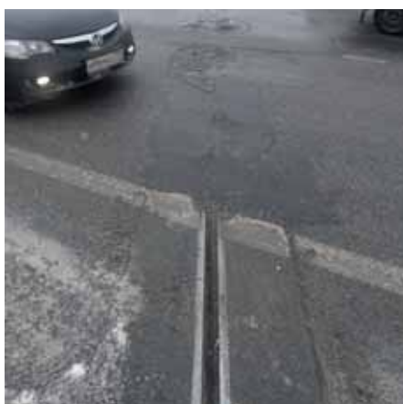
Рис. 3. Перекрытие поврежденного участка деформационного шва с резиновым компенсатором асфальтобетонным покрытием
