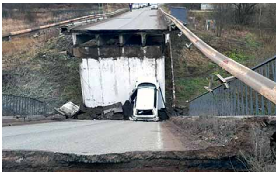
Рис. 1. Обрушение пролетного строения автодорожного моста в Московской области вследствие разгерметизации деформационного шва с последующим обводнением и разрушением конструкции ригеля промежуточной опоры
