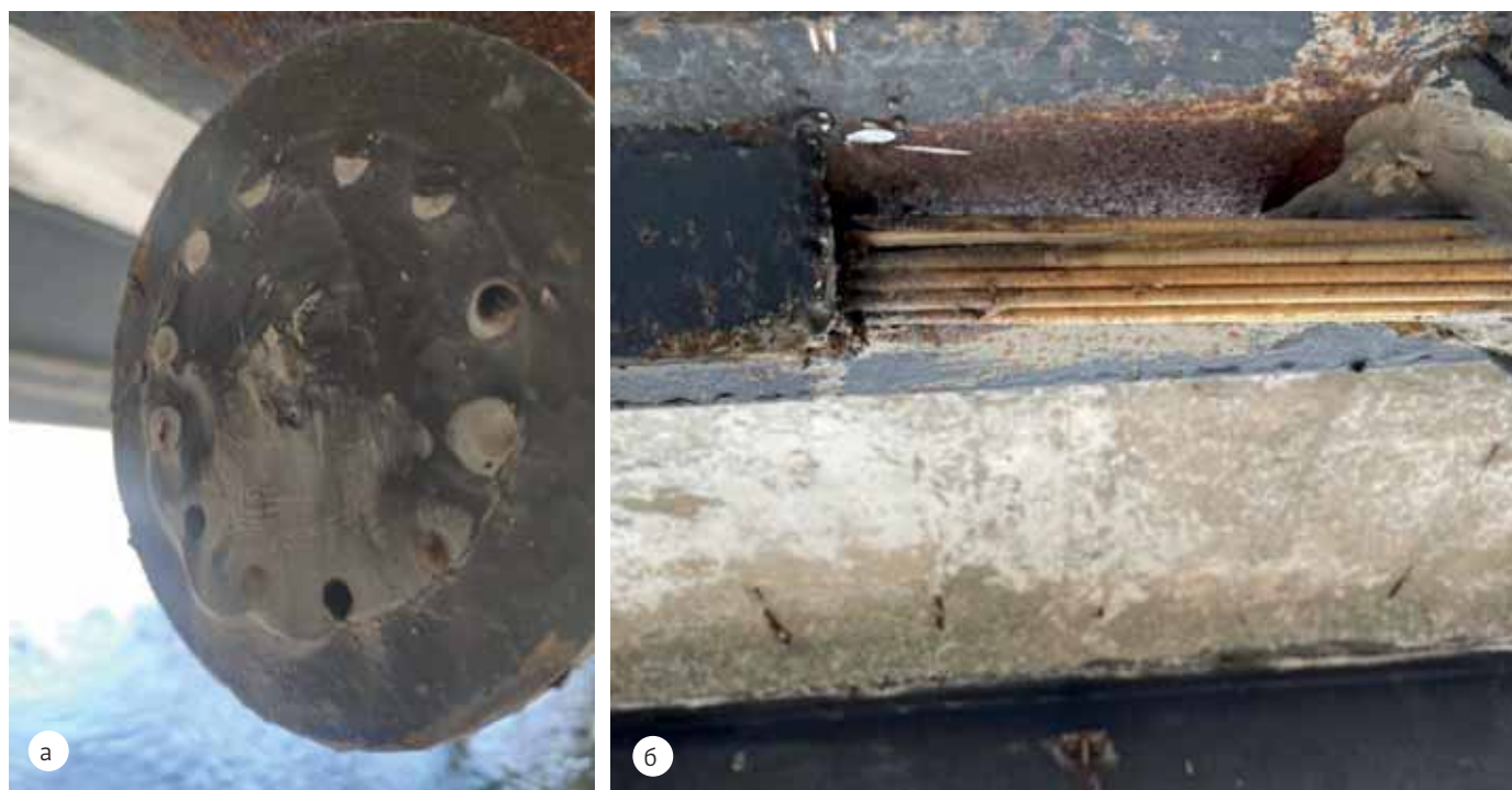
Рис. 7. Общий вид торца анкерного устройства (а) и пучка предварительно напряженных стержней стеклопластиковой арматуры (б). Снимки сделаны во время обследования в 2022–2023 годах
