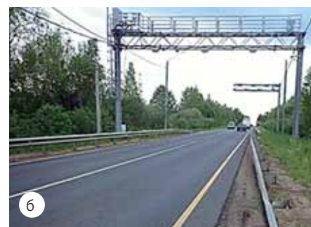
Рис. 1 (а, б). Общий вид участка АПВГК на автомобильной дороге. Колея по полосам наката и отсутствие укрепленной обочины до барьерного ограждения по типу проезжей части, отсутствие прикромочного лотка
