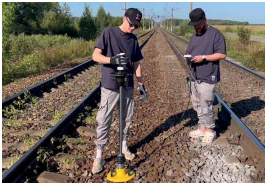
Коммерческий и генеральный директор «Грин-Тех» с Прототипом динамического плотномера «Импульс-1Д» На экспериментальном участке железнодорожного полотна под Рязанью
