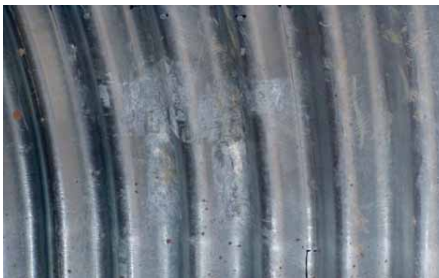
Рис. 8. Начальная стадия коррозии свода
