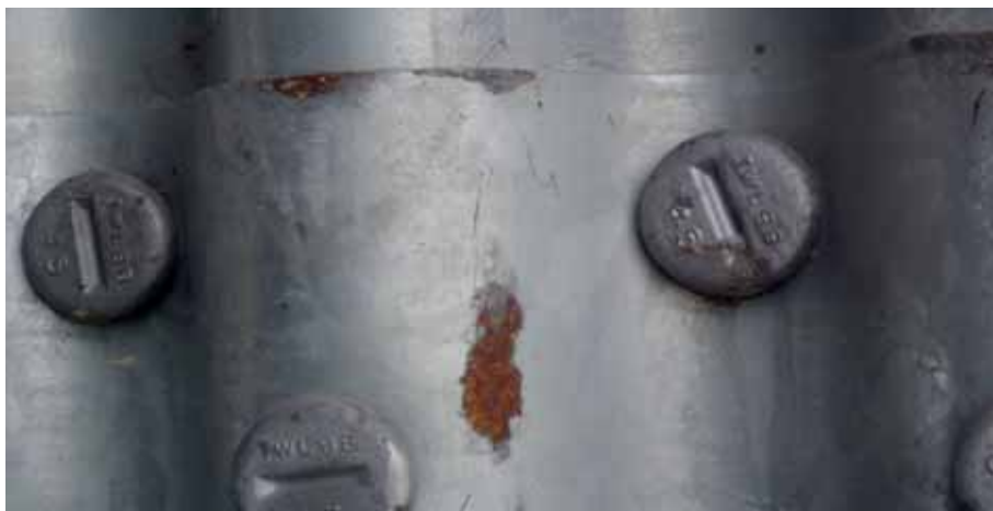
Рис. 11. Коррозия стали в местах повреждения заводского цинкового покрытия
