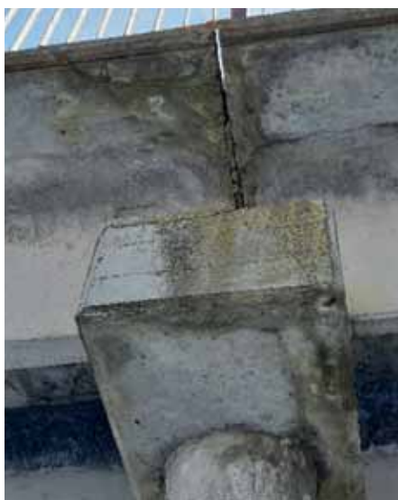
Рис. 5. Намокание крайних балок пролетного строения, ригеля, опоры. Мост через реку Сура
