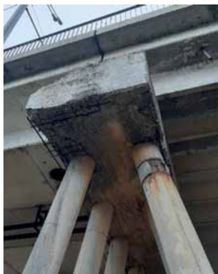
Рис. 6. Дефекты: разрушение защитного слоя бетона, скол, коррозия арматуры
