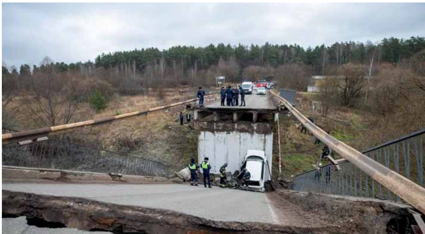
Рис. 3. Обрушение моста в Московской области (река Пахра)
