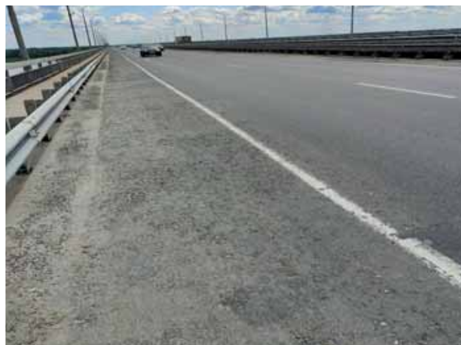
Рис. 3. Состояние дорожной одежды на мосту через Волгу по направлению к Энгельсу
