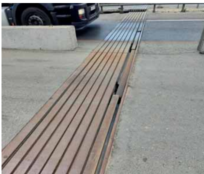
Рис. 4. Разрушение одного из деформационных швов на пролетном строении условного моста
