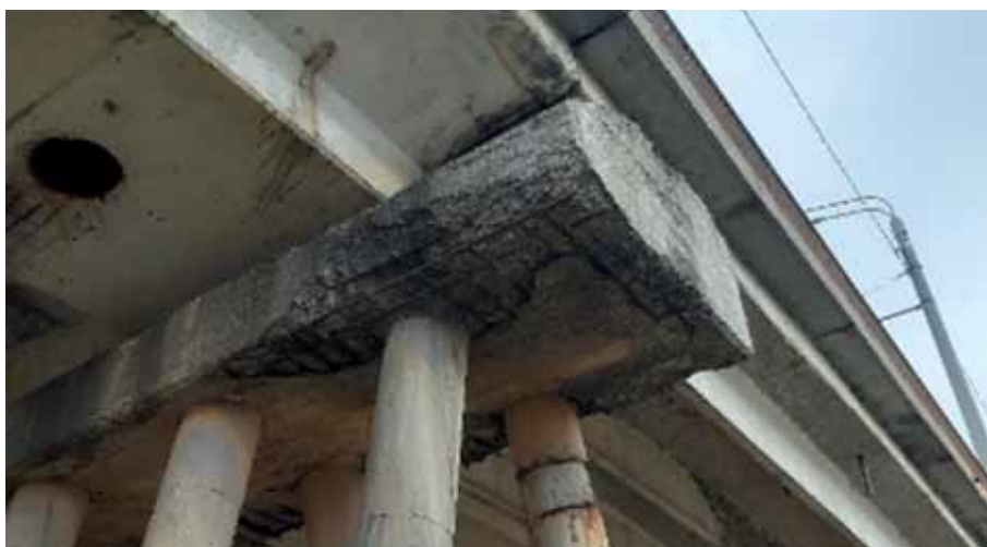
Рис. 14. Разрушение несущих конструкций Сурского моста (главных балок, ригеля, опор)
