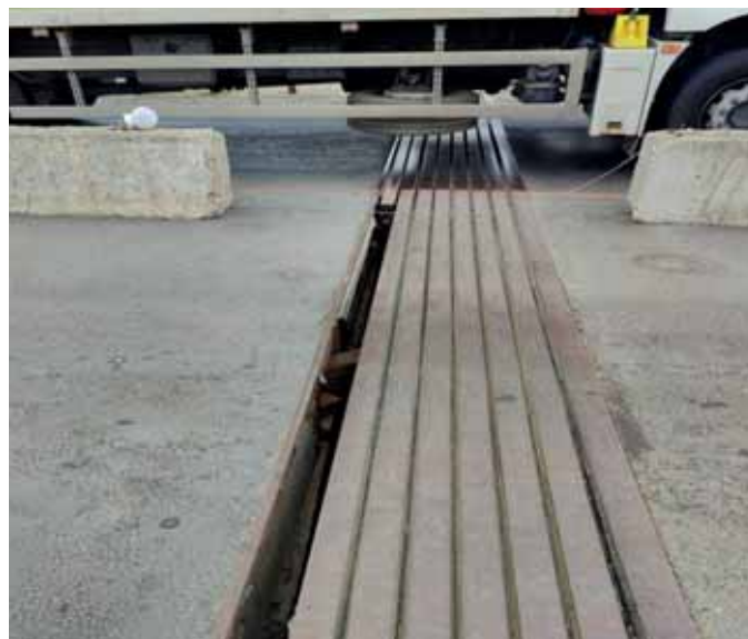
Рис. 5. Разрушение другого деформационного шва на пролетном строении условного моста
