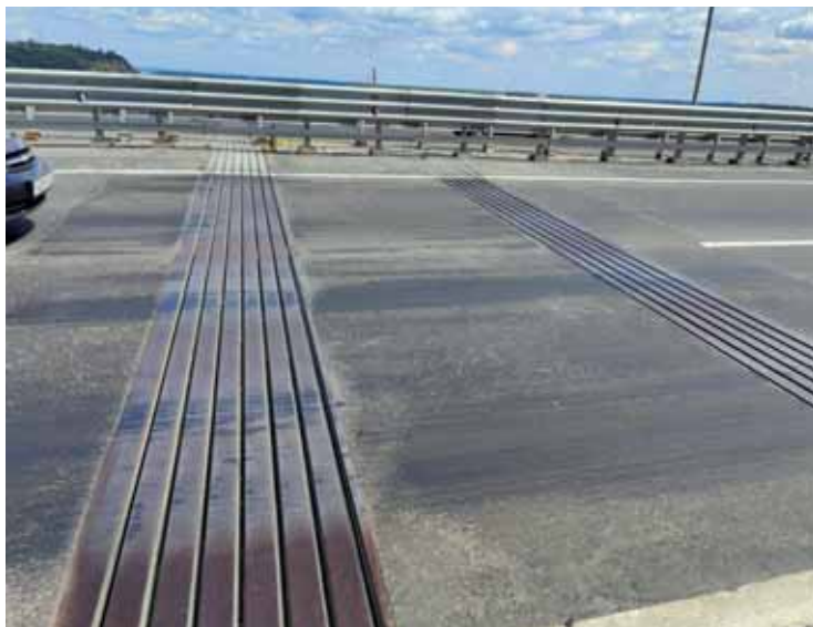
Рис. 6. Состояние деформационных швов на опоре, где стыкуются две плети пролетного строения
