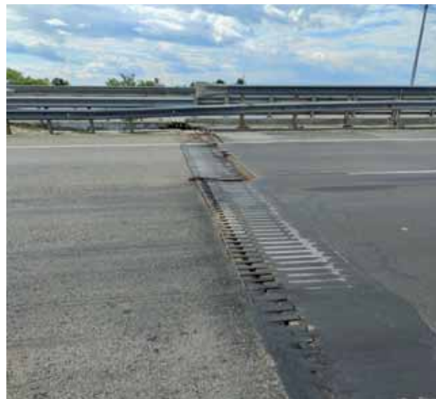
Рис. 7. Состояние гребенчатого деформационного шва на мосту через протоку
