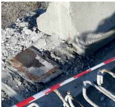
Рис. 11. Раздавливание РОЧ. Место положения – крайняя балка пролетного строения
