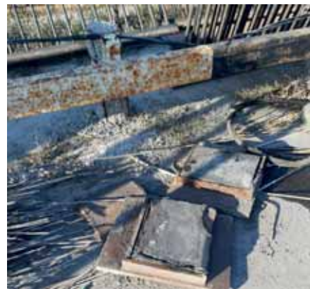
Рис. 13. Нарушение целостности листа рубероида (гидроизола) опорной части железобетонного моста
