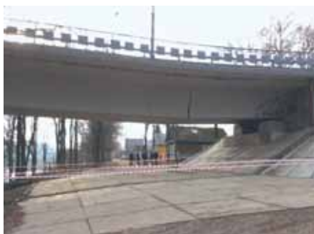
Фото 2. В пролете 5–6 произошло разрушение стыков между Б3-Б4 и Б4-Б5 с образованием глубокого провисания блока Б4 на 51 см
