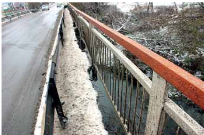
Рис. 3. Пролет 2, тротуар справа. Разрушение бетона, нарушение анкеровки перил, коррозия металлических элементов
