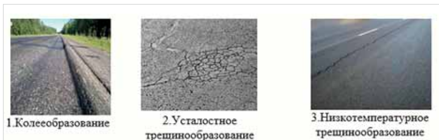
Рис. 1. Дефекты дорожного покрытия
