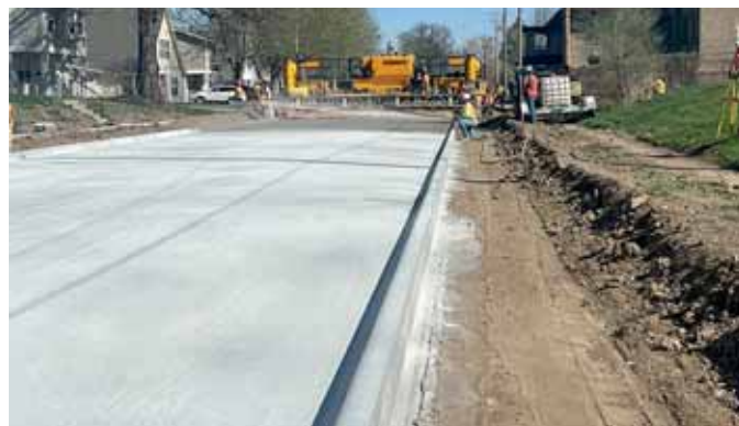
Нанесение пленкообразующего на уложенное покрытие городской улицы (после прохода бетоноукладчика с одновременным формованием бордюров с обеих сторон дороги)
