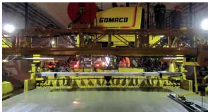
Устройство из цементобетона путевых призм и различных профилей в железнодорожных тоннелях, проезжей части и различных профилей в автодорожных тоннелях с применением универсального бетоноукладчика Commander III в тоннельных комплексах трассы Адлер – горноклиматический курорт «Альпика-Сервис», где впервые в России применена система нивелирования 3D (без струны).
