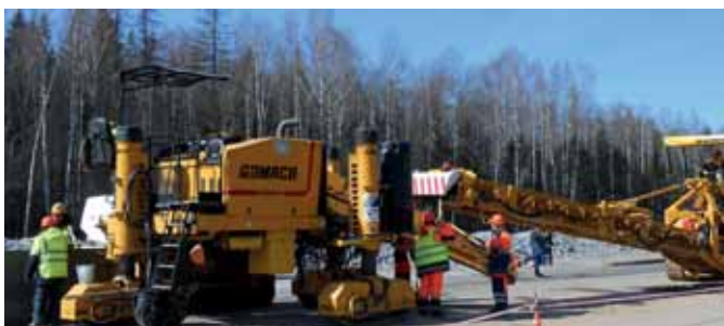
Устройство разделительного ограждения на автомагистрали М11 (Москва – Санкт-Петербург). Работа комплекса в составе: перегружатель RTP500, бетоноукладчик Commander III
