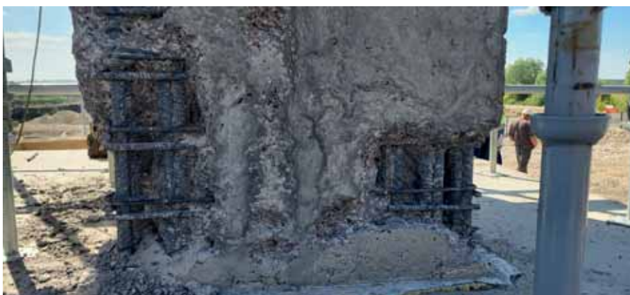
Рис. 2. Непровибрированный участок железобетонной конструкции
