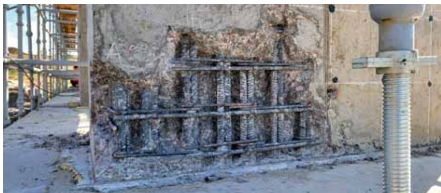
Рис. 1. Непровибрированный участок железобетонной конструкции
