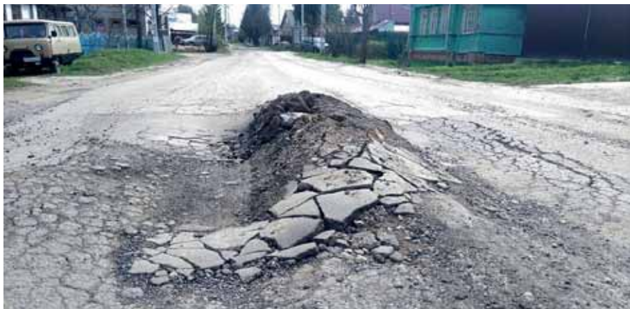
Рис. 5. Разрушение асфальтобетонного покрытия на участке продавливания дорожной одежды – по причине переувлажнения земляного полотна [3]
