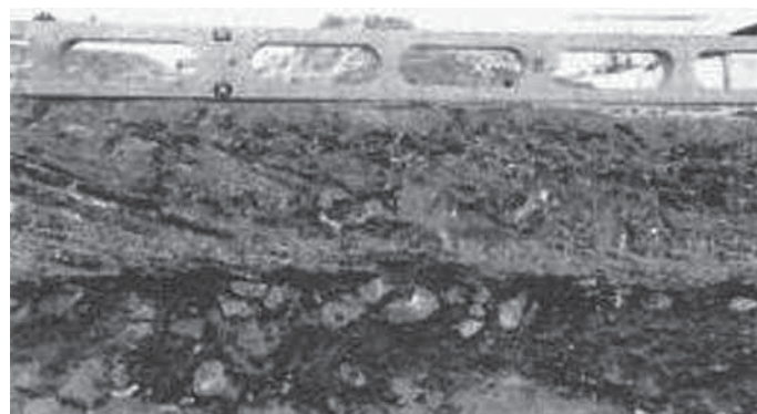
Рис. 12. Дegradaция щебеночного и песчаного слоев дорожной одежды в процессе службы дороги вследствие вертикальных перемещений минеральных частиц в процессе виброколебаний одежды при движении автомобилей (фото из работы [8])
