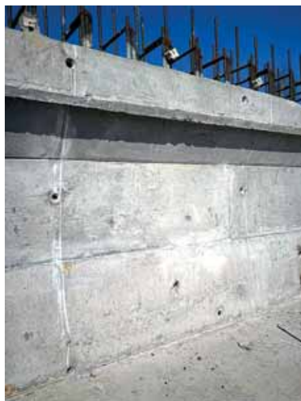
Рис. 4. Температурные трещины в шкафной стенке опоры
