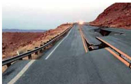
Рис. 3. Разрушение асфальтового покрытия по причине разрушения земляного полотна автомобильной дороги [3]
