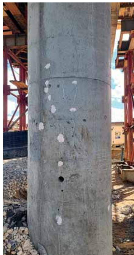
Рис. 3. Температурно-усадочные трещины в стойке опоры
