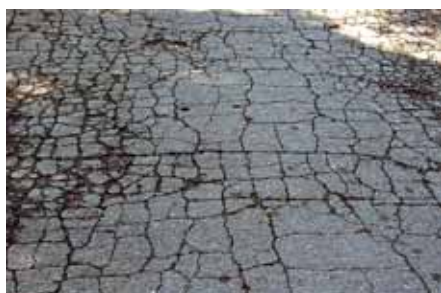
Рис. 7. Разрушение (дробление) асфальто-бетонного дорожного покрытия [интернет]
