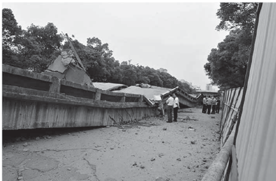
Рис. 6. Разрушение виадука в Китае [2]
