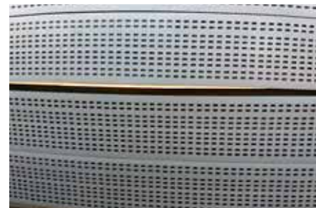
Фото 2. Выгиб панели в ходе жизненного цикла
