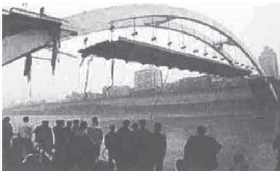
Рис. 5. Разрушение моста в провинции Сычуань [3]
