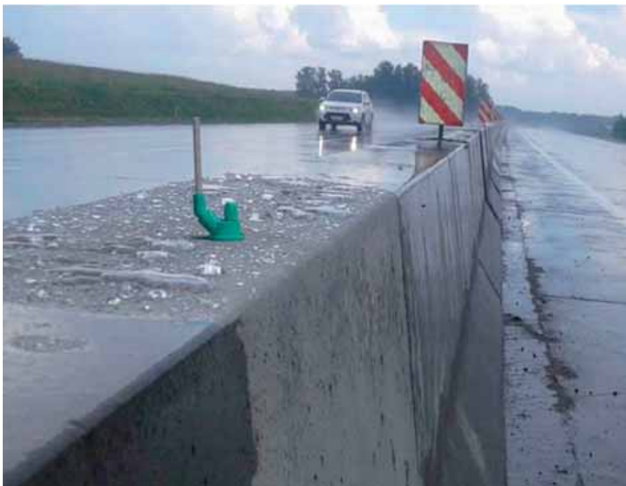
«Трубка САЗИ» на осевой линии (измерение водонепроницаемости бетона после гидрофобизации с помощью «Трубки САЗИ»)
