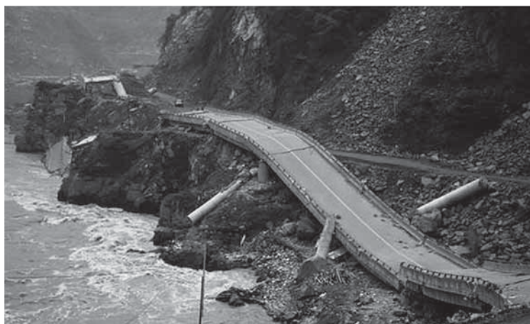
Рис. 3. Прогрессирующее разрушение моста вследствие землетрясения [2]
