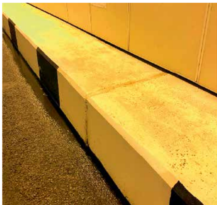
После ремонта шва с заменой герметика на «Сазиласт 501» и «Сазиласт 502» дефектов нет
