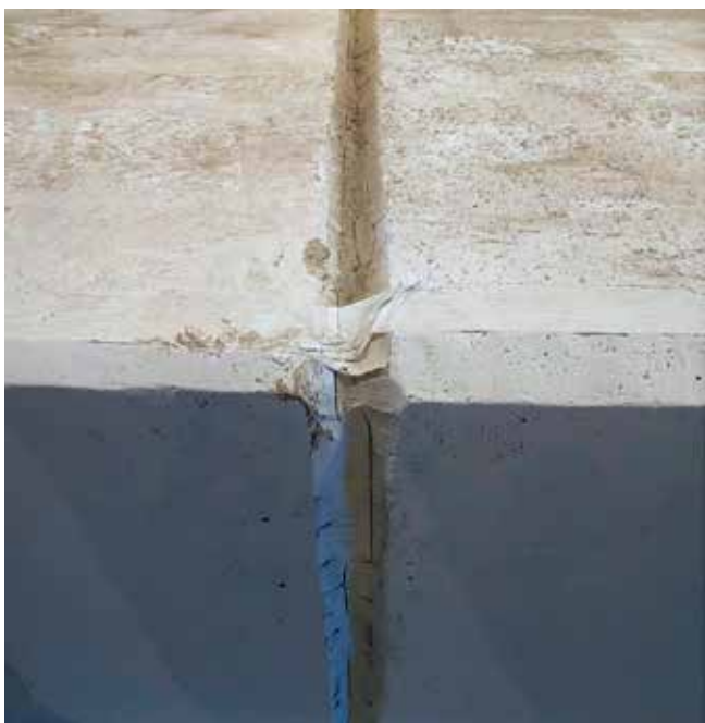
Разрушение шва из-за ошибочно примененного герметика «Сазиласт 24» и «Сазиласт 25»
