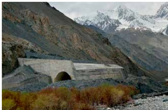
Рис. 8. Элемент инженерной защиты трассы Каракорумского шоссе от оползней и селей [3]
