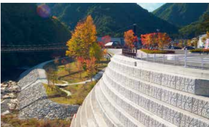
Рис. 8. Берегоукрепительное сооружение в виде криволинейной в плане подпорной стены из блоков КБП
