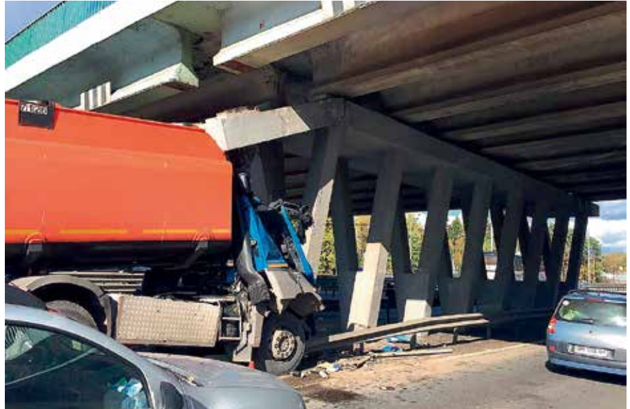
Повреждение промежуточной опоры путепровода после наезда бензовоза
