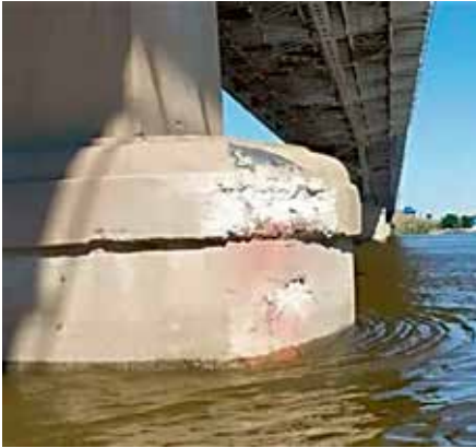
Повреждение опоры моста после столкновения с судном
