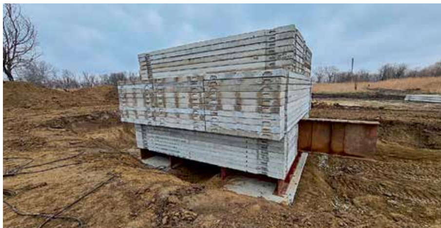
Рис. 3. Грузовая платформа для статических испытаний забивной сваи сечением 40x40 см вертикальной вдавливающей нагрузкой 175 т
