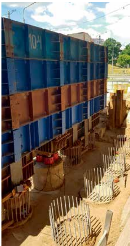
Рис. 2. Система анкерных балок стенда для статических испытаний бурового столба диаметром 1,5 м вертикальной вдавливающей нагрузкой 1400 т
