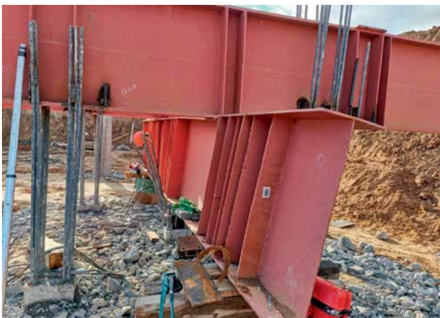
Рис. 5. Разрушение анкерных балок стенда для статических испытаний забивной сваи
