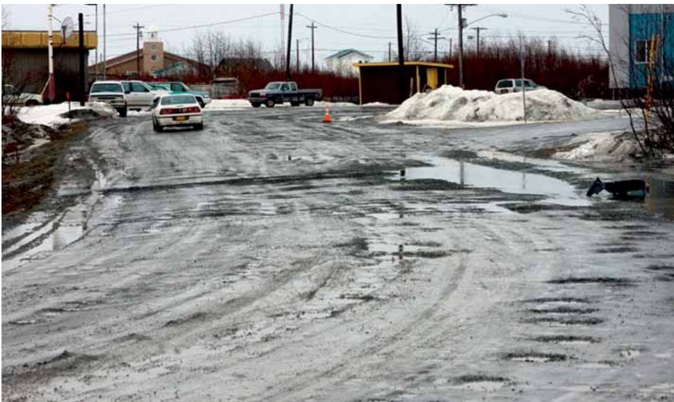
Рис. 7. Дефекты дорожного покрытия на трассе Аляски
