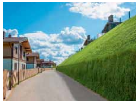
Рис. 11. Подпорная стенка из габионных конструкций RockBox. Жилой комплекс «Образ жизни. Горная деревня». Санкт-Петербург
