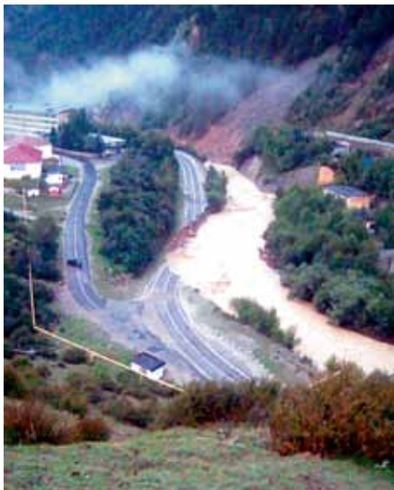
Рис. 3. Курорт «Эльбрус». Река Баксан. Федеральная дорога Прохладный – Азау (2017). Фото из архива МЧС России
